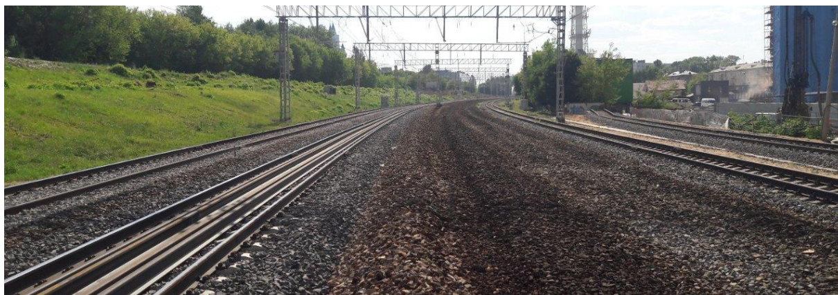
Рис. 4. Вид на участок реконструкции железнодорожного пути на перегоне Фили – Кунцево Московской ж.д.
