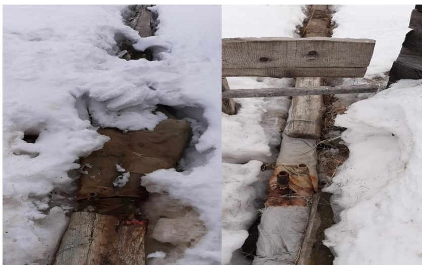
Рис. 2. Примеры теплоизолированных трубопроводов в сельской местности
