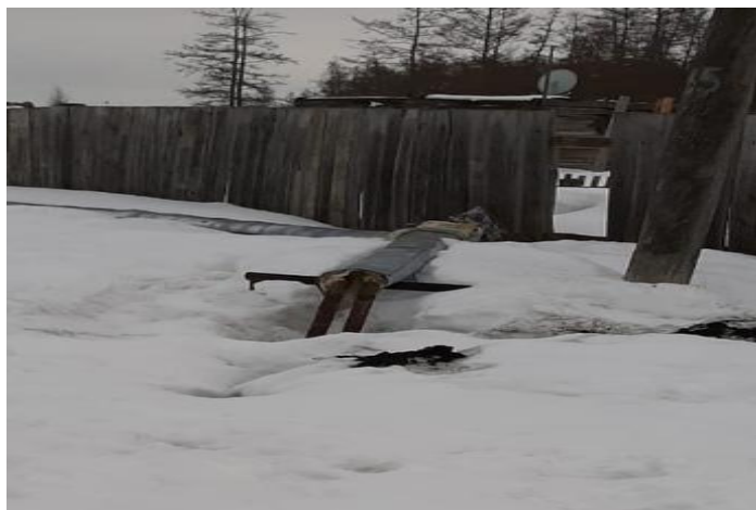
Рис. 1. Магистральный трубопровод теплоснабжения
